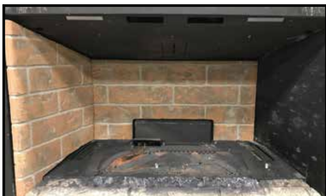
Figure 5 Réfractaire gauche installé
