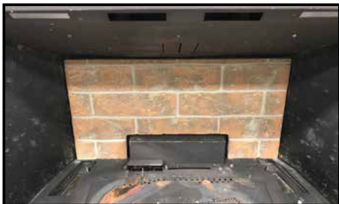
Figure 4 Réfractaire arrière installé
