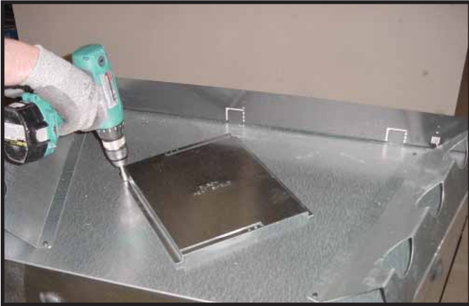
Figura 7.1 Si va a realizar una ventilación trasera, omita este paso. Para una ventilación superior, retire los dos tornillos que sostienen el escudo térmico. Coloque éste escudo sobre el primer codo si lo es pertinente.
