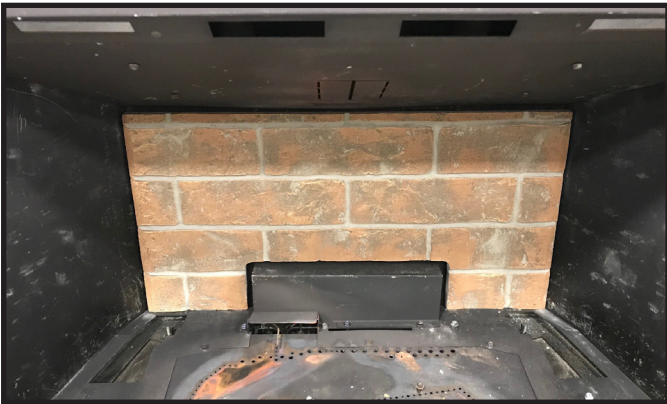
Figure 4 Réfractaire arrière installé
