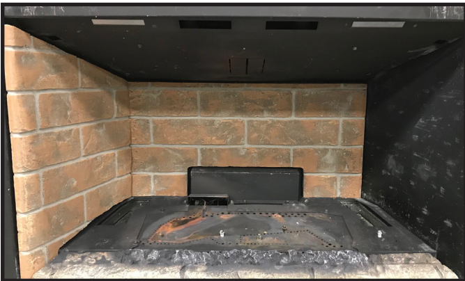
Figure 5 Réfractaire gauche installé
