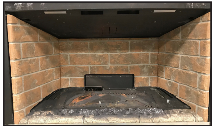
Figure 8 Trousse du réfractaire installé
