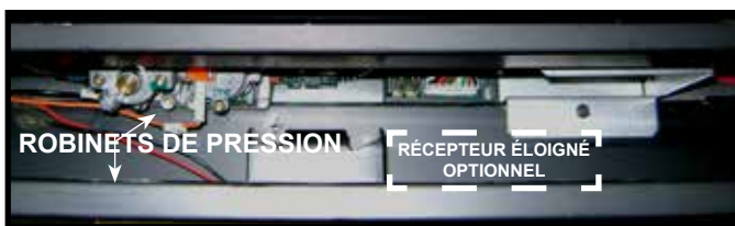
Figure 11.5 Localisation des robinets de la vanne de pression et du récepteur éloigné
