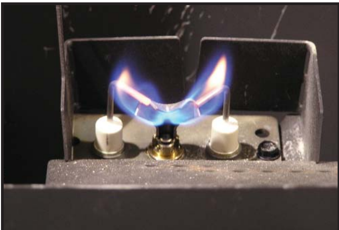
Figura 3.1 Aspecto de las llamas de un piloto IPI
